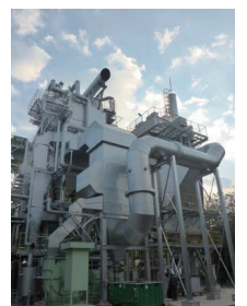
木質バイオマス発電所
