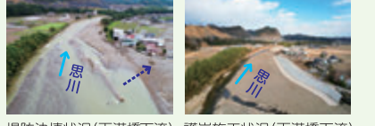
堤防決壊状況(天満橋下流) 護岸施工状況(天満橋下流)
